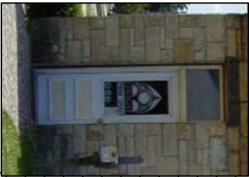
REPLACE MODERN DOORS
